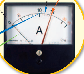
送水ポンプ電流計
