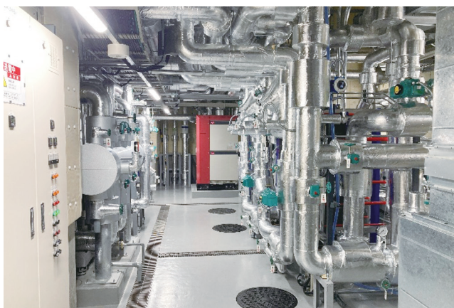
図4 熱源機械室廻り
