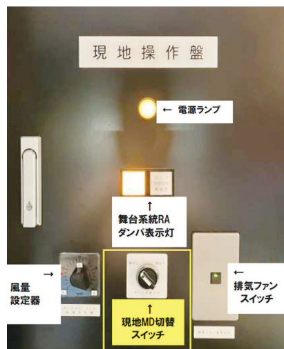
図6 舞台幕揺れ対策用現地操作盤
