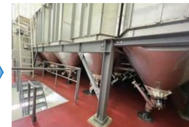
精米前の玄米がある部屋を、雪冷房で5～8℃に空調
