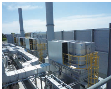
蓄熱燃焼式排ガス処理装置
